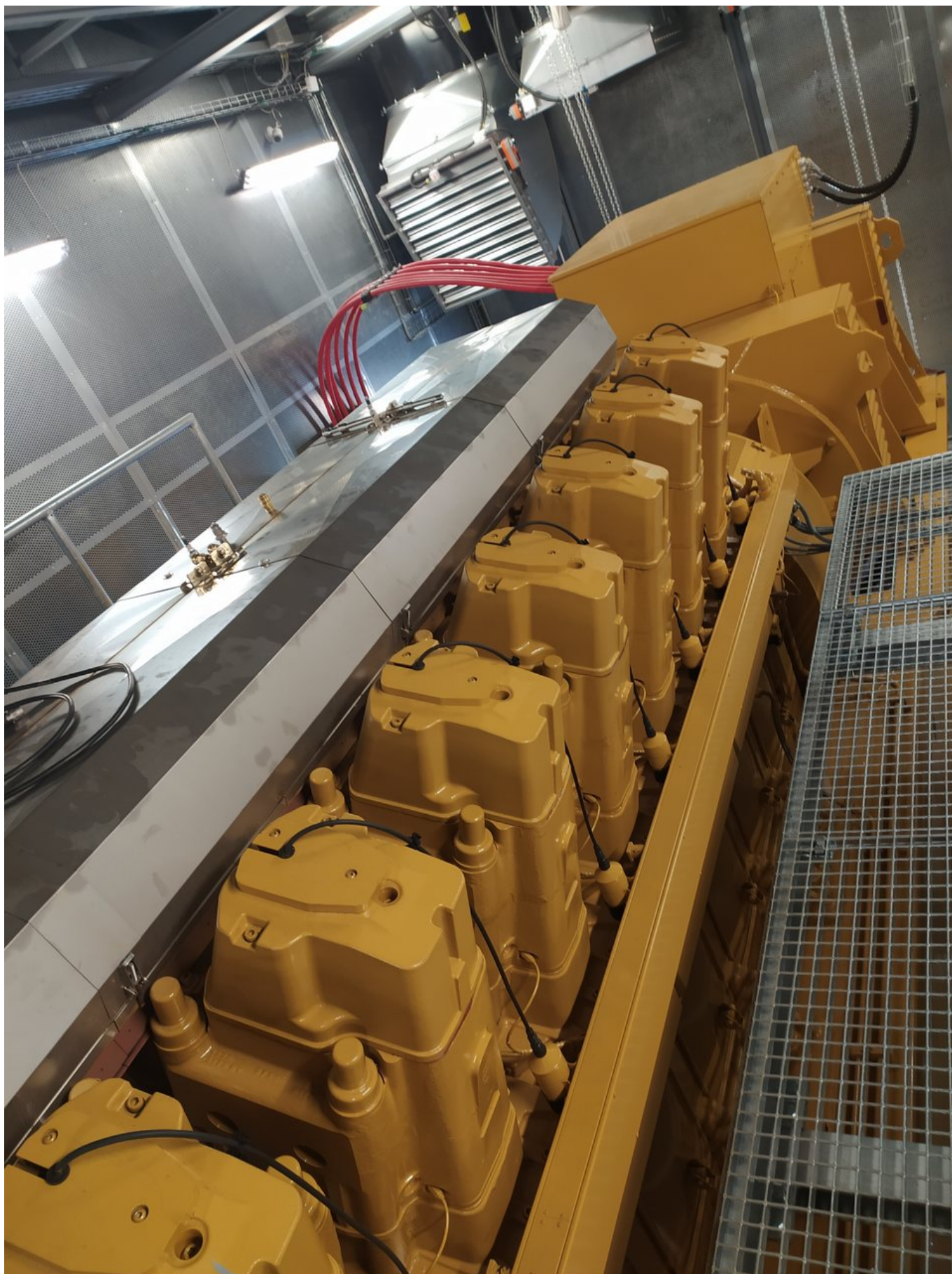
Agregat kogeneracyjny (CHP) marki Caterpillar CG 260-16.
